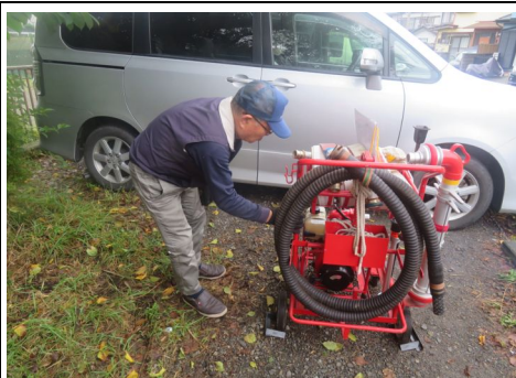
D級ポンプ点検の様子
