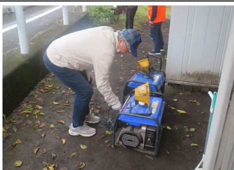
発電機と投光器点検の様子
