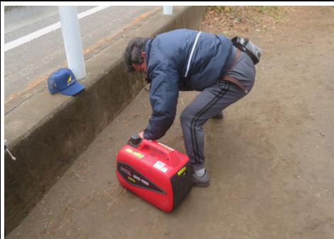
発電機点検の様子
